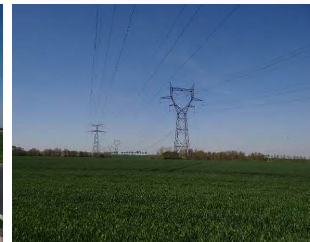
Photo 20 : Ligne haute-tension à Nesle (Source : BE JC)
